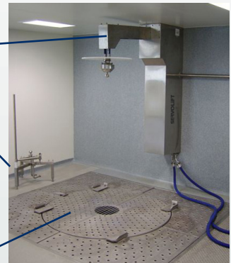
(3) (4) Zone de lavage avec potence et tête de lavage mobile
