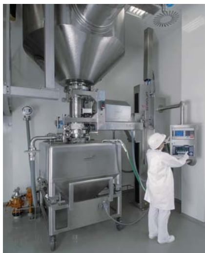
Installation de déchargement de séchoir, calibrage, dosage, conditionnement confiné OEB 5
